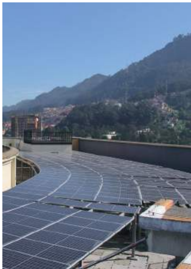
Paneles solares Dirección General, Bogotá.
